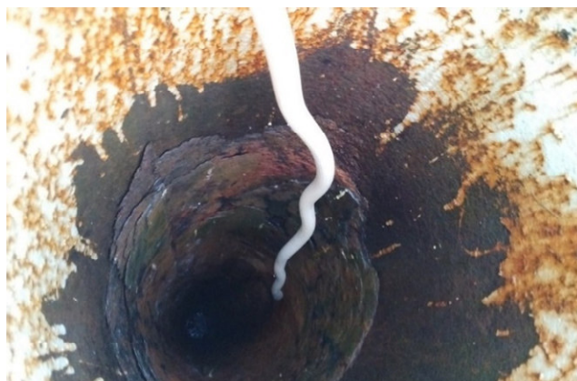
Corrosion constatée sur le forage T1
