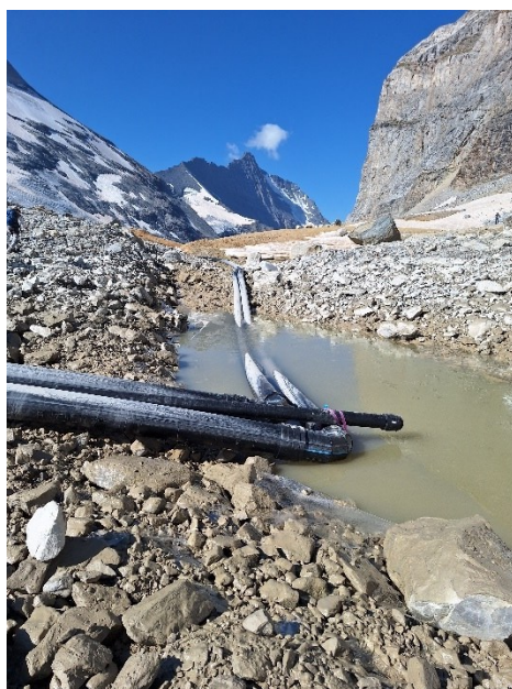
Photo 24 : Passage de l'eau issue de la vidange dans les conduites
