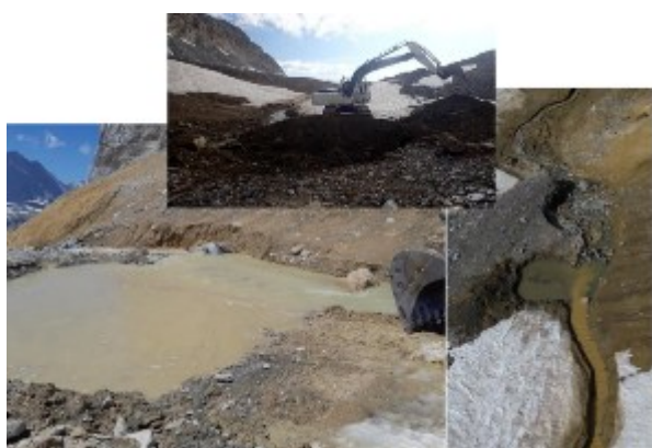
Photo 2, Photo 3, Photo 4: Bac de décantation rustique (source RTM, 2023)
