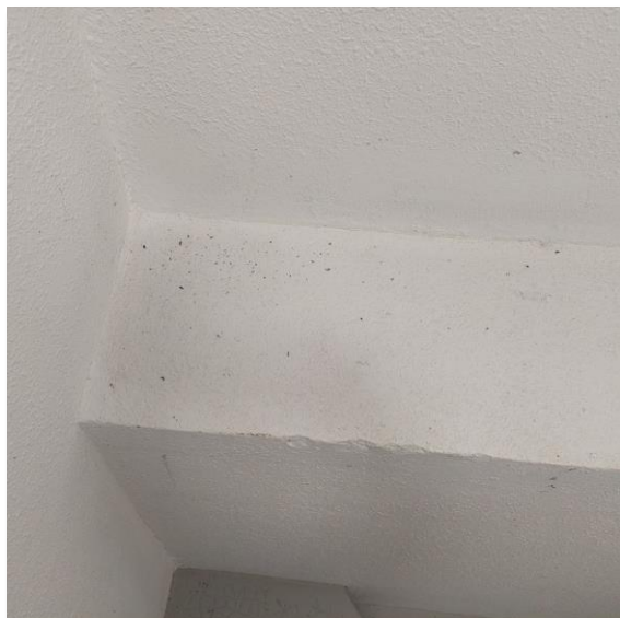
Guano dans l'escalier menant au sous-sol depuis les cuisines. Les conditions de luminosité indiquent que cette zone est fréquentée en phase de repos nocturne.
