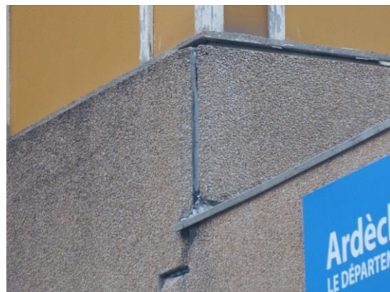
Les jonctions d'éléments de béton préfabriqué au niveau des arêtes de bâtiments sont (dans la plupart des cas) jointées au silicone, ne donnant pas accès aux espaces à l'arrière de ces éléments
