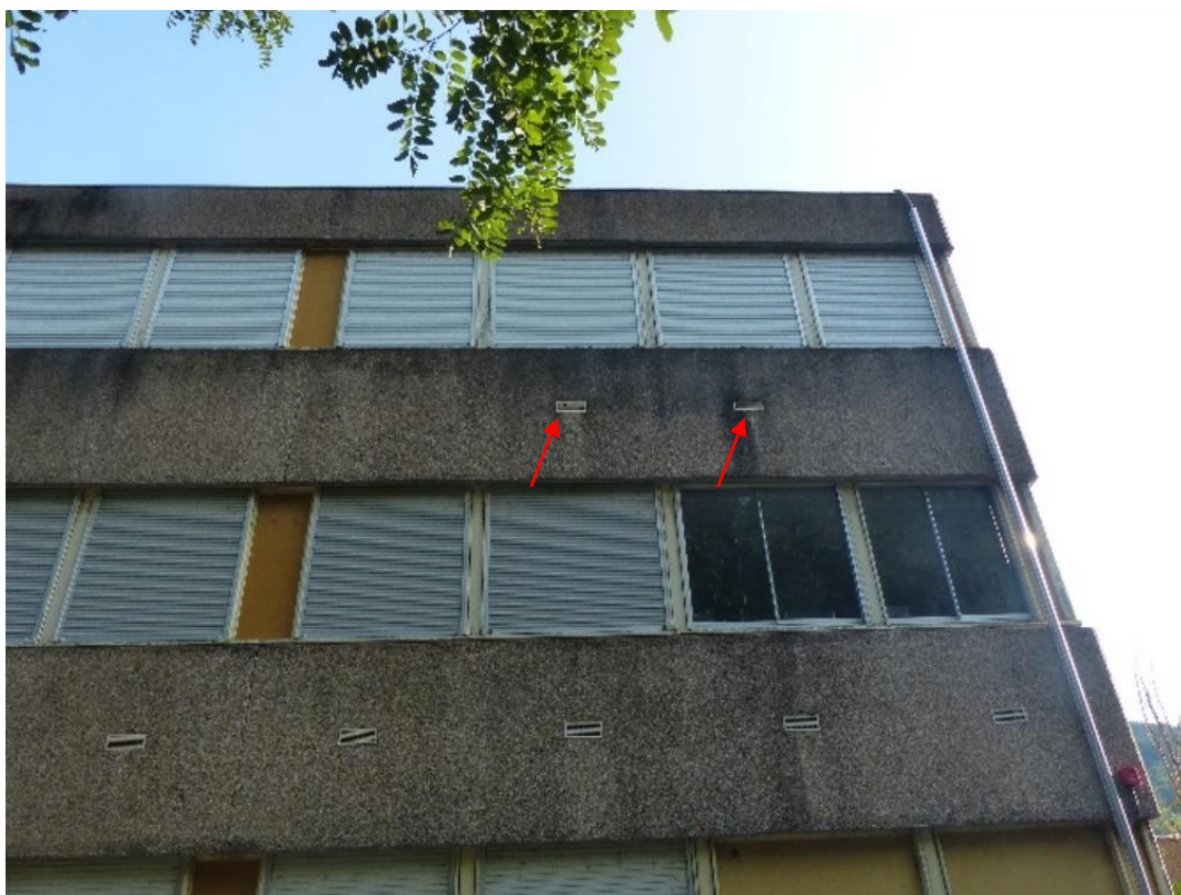
Sur les deux bâtiments, une grande partie des grilles obturant les gaines d'aération des bâtiments présente des défauts...
