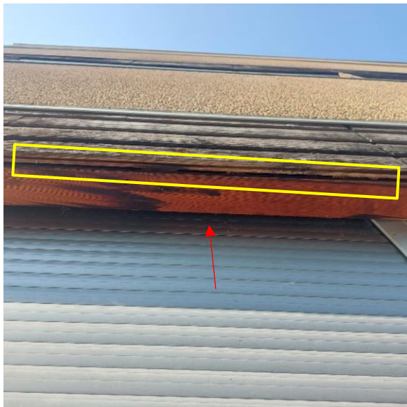
Ces espaces sont accessibles à la faveur de décollements des planches avec le support du bardage (rectangle jaune) ou par l'espace à l'avant du volet roulant (flèche rouge)
