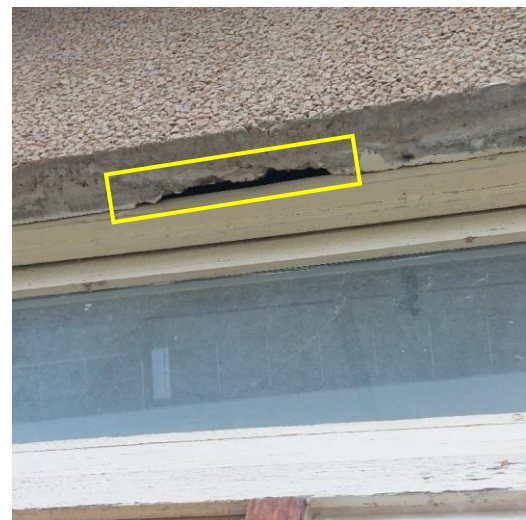
Au niveau des huisseries du bâtiment 1, des défauts dans le béton offrent un accès à ces espaces pour la faune.
