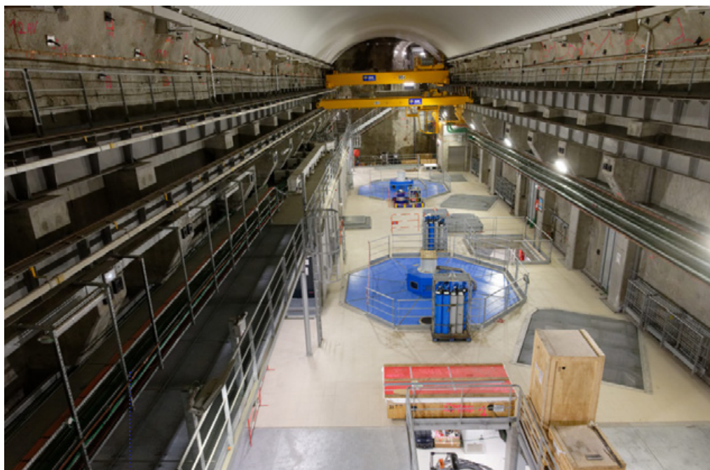
Caverne « usine » avec les 2 groupes existants et l'emplacement en attente du G3 au premier plan
