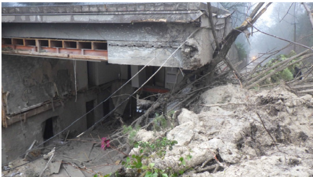
Glissement du 30/12/2017 à Claix
