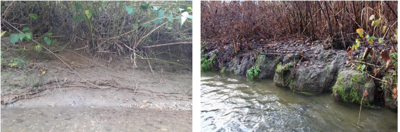
Figure 59 : Illustrations d'érosion de berge sur la lône des Cerisiers. A gauche : août 2021 ; à droite : décembre 2020. Source : SHR.
