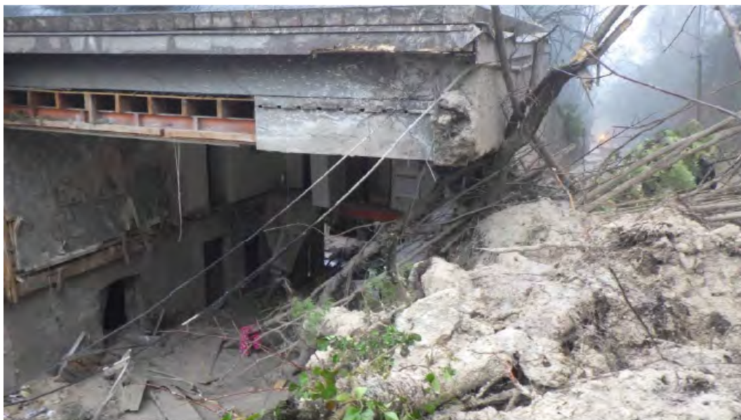
Glissement du 30/12/2017 à Claix
