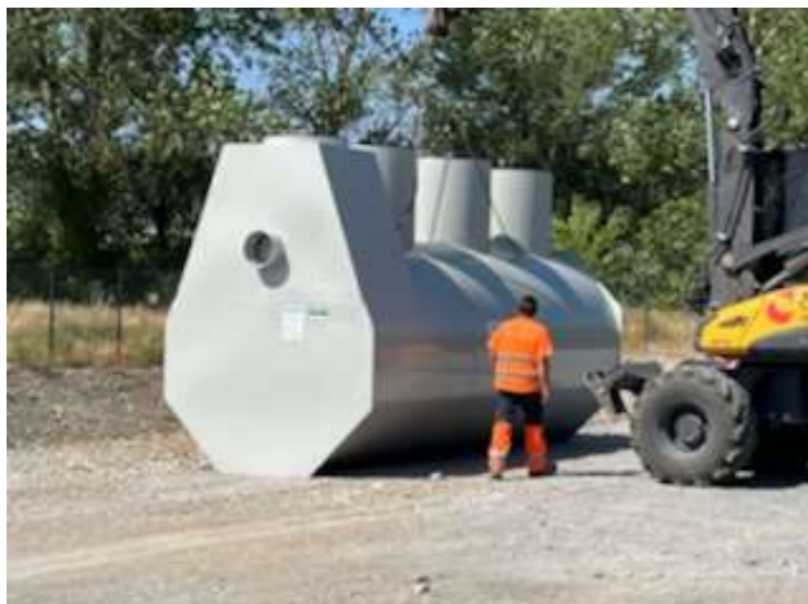
Plateforme SOLUWASTE : déboureur/séparateur d'hydrocarbures sur le site avant sa mise en place (cliché TS 09/22)
