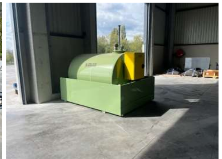
Plateforme SOLUWASTE : Stockage de 3000 l d'hydrocarbures et pompe de distribution sur cuvette de rétention elle-même sur dalle étanche, sera placée dans la partie fermée du bâtiment (cliché TS 09/22)
