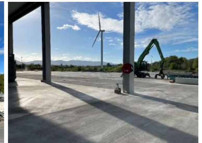
Plateforme SOLUWASTE : exemple de dispositif du réseau d'extinction incendie dans partie ouverte du bâtiment (cliché TS 09/22)
