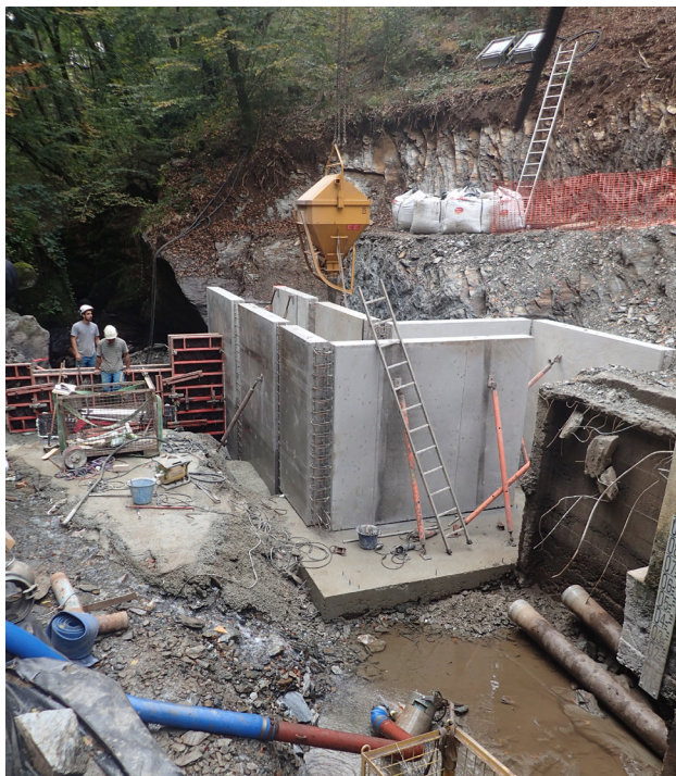
Photo 2 : Construction de la passe à poisson, terrassement et préparation de la structure devant accueillir la vanne (28/09/2017)
