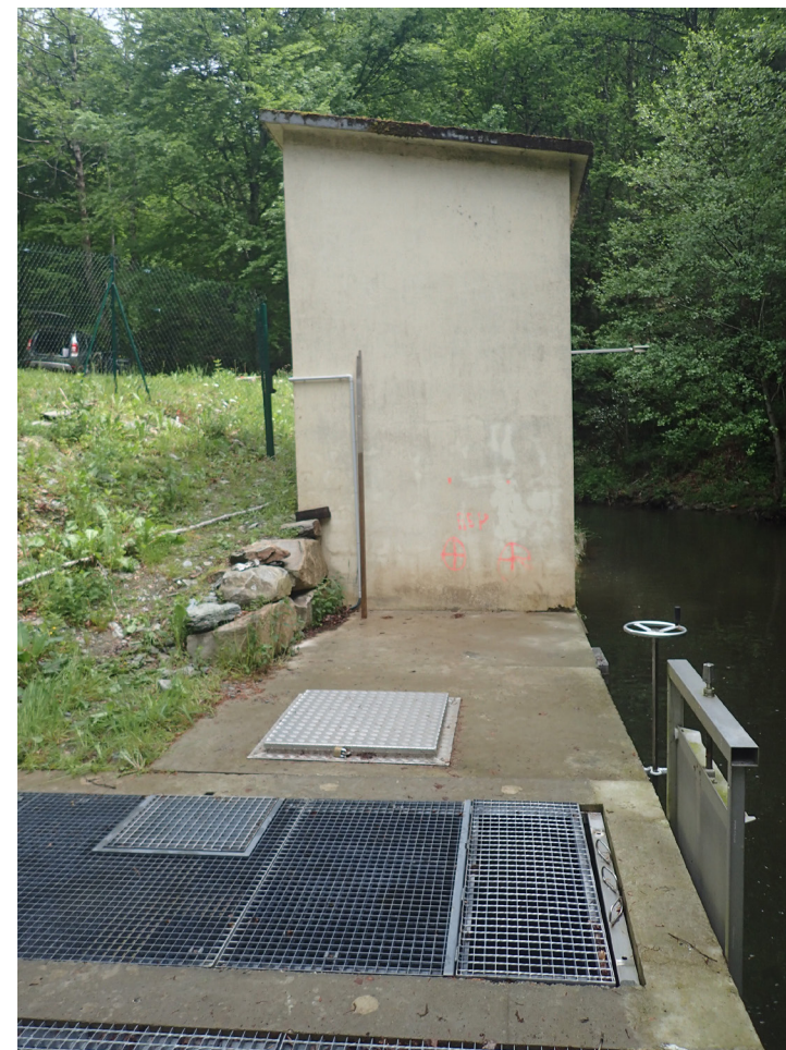
Photo 2 : Station de pompage sur la Ressègue à Martory depuis l'intérieur du périmètre de protection immédiat le 28/05/2019
