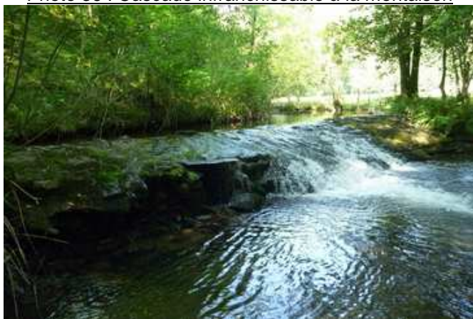
Photo 38 : Seuil infranchissable à la montaison
