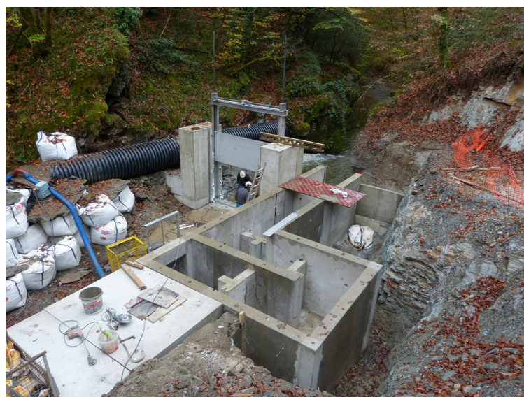
Photo 4 : Mise en place de la vanne levante avant construction de la passerelle (27/10/2017)
