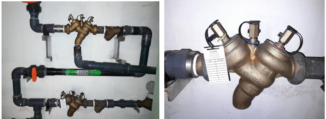
Figure 22 : Photo du disconnecteur
