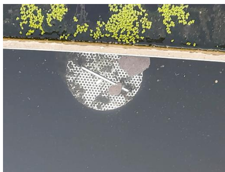
Figure 28 : Crépine d'aspiration de l'ouvrage de clarification
