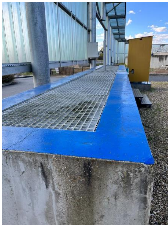
Figure 16 : Canal de comptage des eaux traitées avec son préleveur
