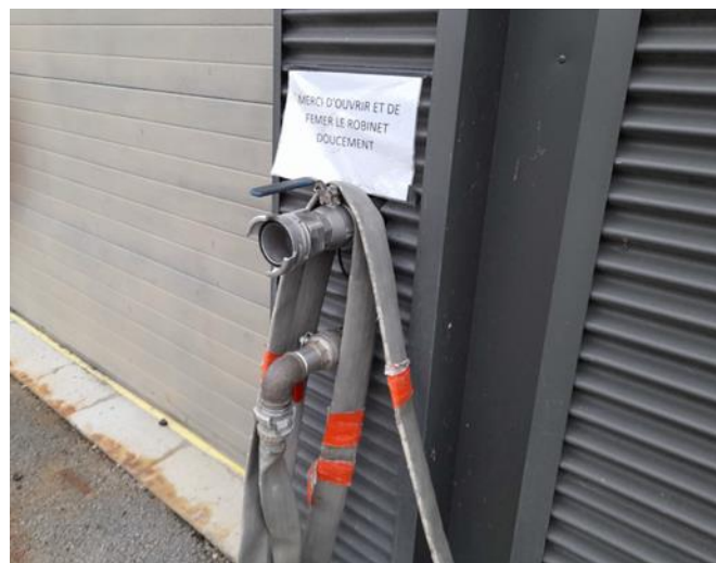
Figure 33 : Photo du raccord pompier de prélèvement des EUT par les utilisateurs et point de prélèvement de la qualité des EUT
