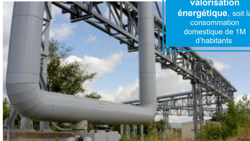
Réseau de chaleur de Trédi Salaise (Isère), qui alimente la plateforme chimique de Roussillon
