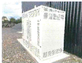
Exemple d'une armoire technique
