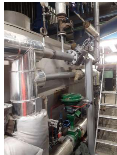
Vannes de réchauffage de la bâche alimentaire
