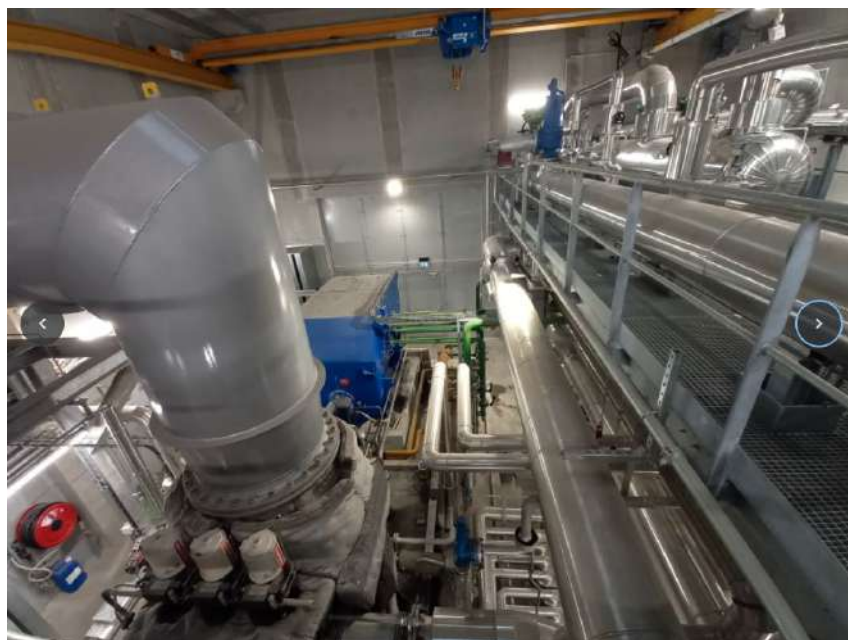
Raccordement électrique nouveau GTA
