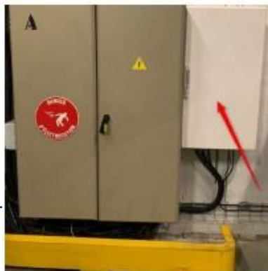
Armoire ajoutée permettant de déporter les départs de production
