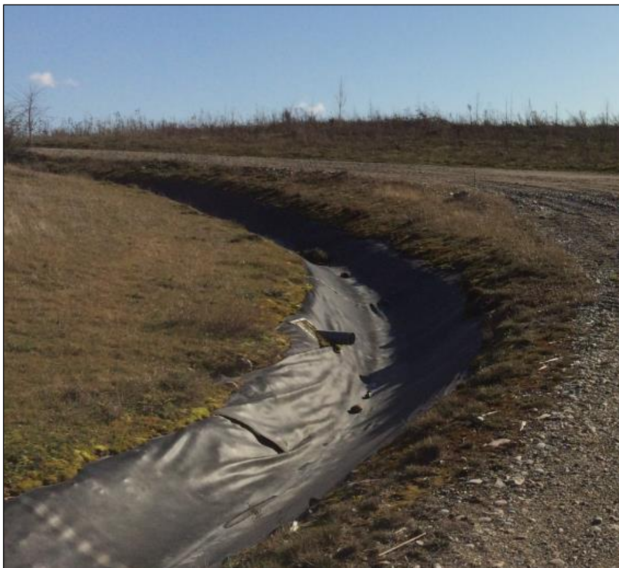
Figure 15 : Fossé pluvial et sortie de drain sur Satolas 1 (Source : EKOS 12/02/2020)
