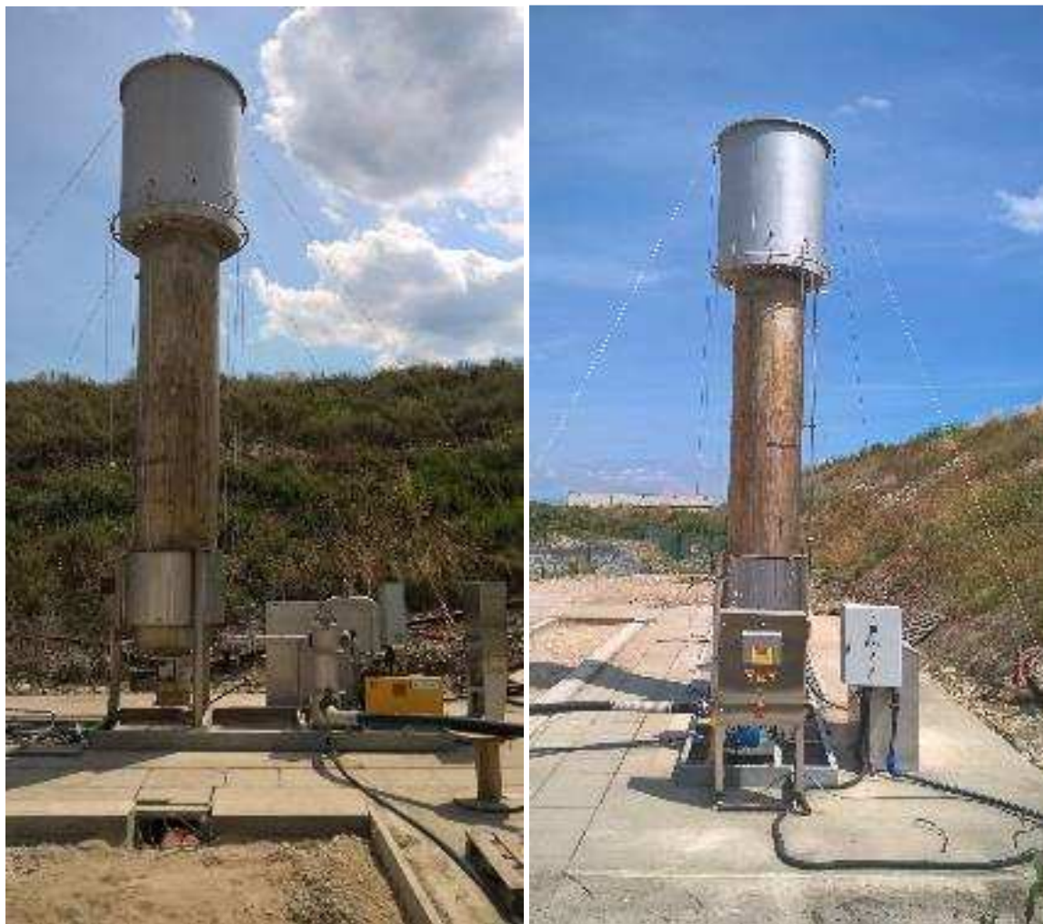
Unité de traitement transvapo
