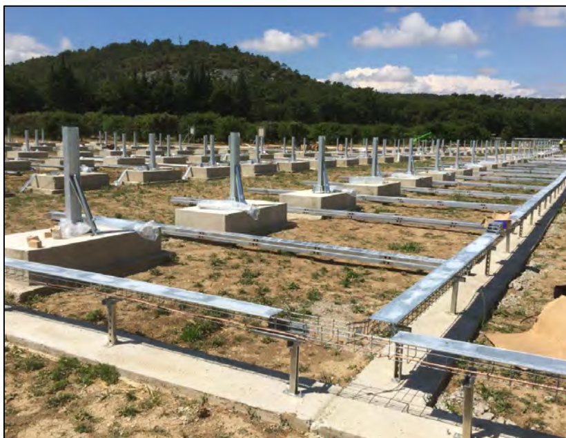
Chemin de câbles « non enterrés » sur longrines béton
