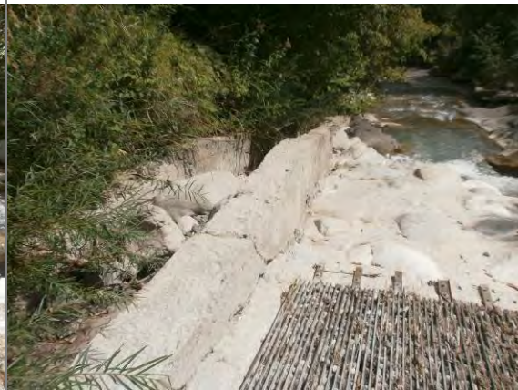
Passe à poissons en rive gauche
