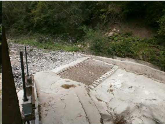
Prise d'eau complémentaire à travers les grilles
