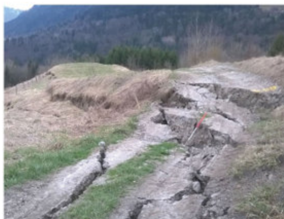
Glissement de terrain à Reyvroz - Haute-Savoie - 2017
