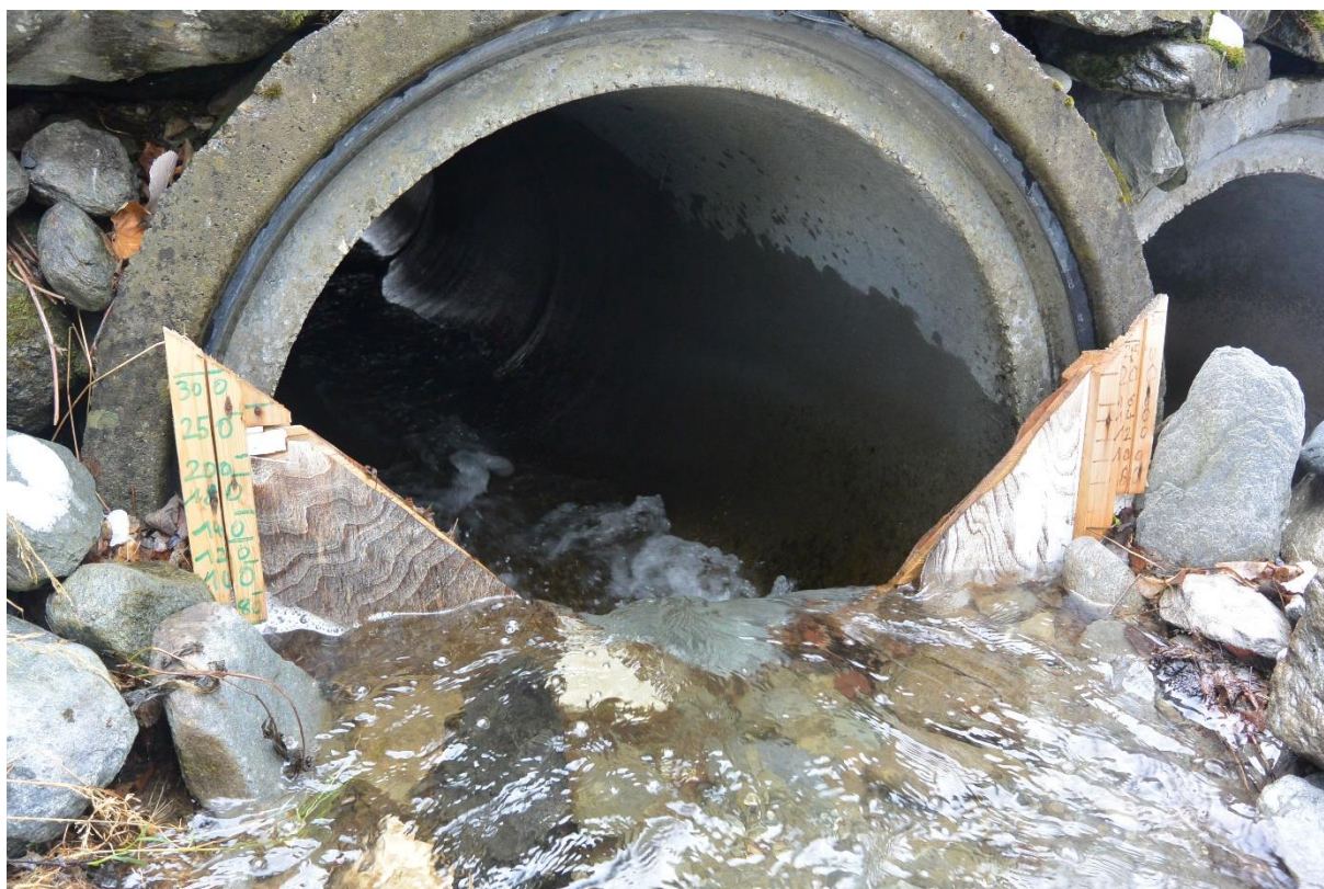
Débit mètre rustique au passage d'un pont sur le Rieu Bénit (Pralognan)
