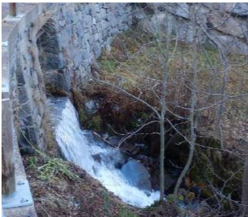
Seuil infranchissable sous un pont
