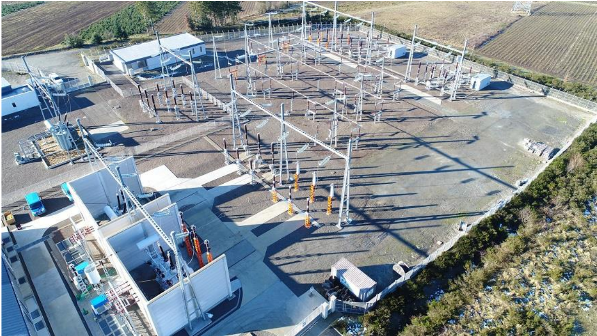
Vue d'un poste source électrique (Enedis)
