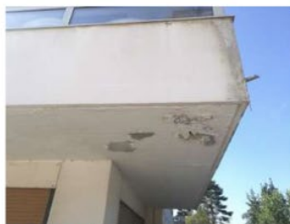
Mauvaise étanchéité des balcons
