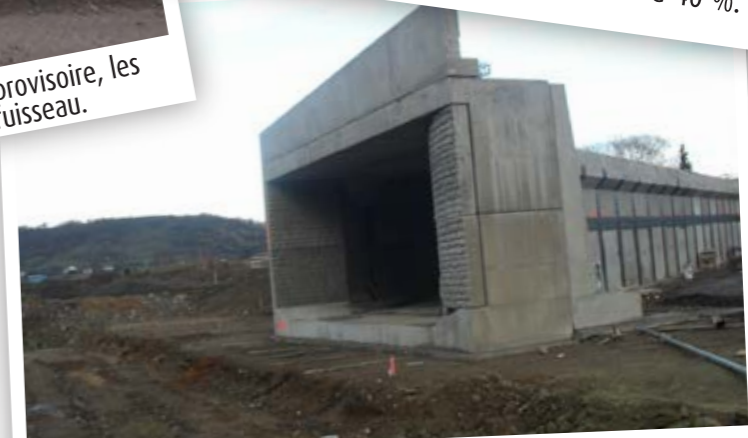
L'ouvrage de rétablissement de la voie verte Genebret - Chartreuse est en cours de finalisation.
