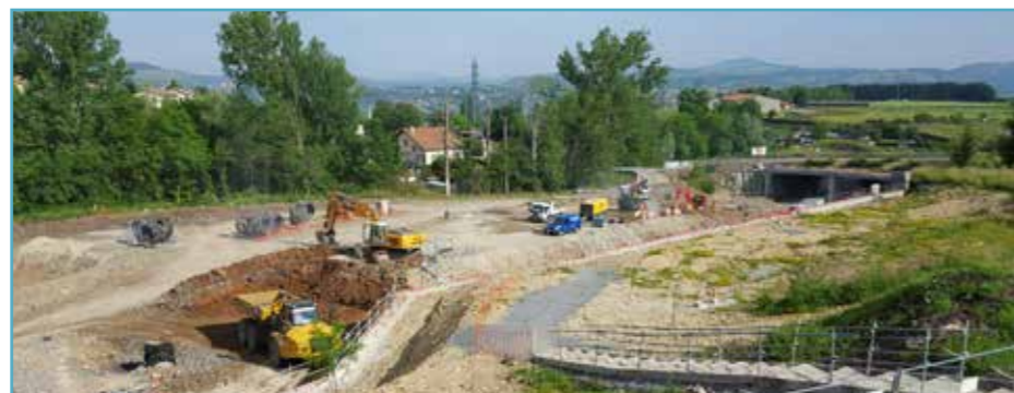
Côté sud de la tranchée, le chantier bat son plein depuis mars 2016.
