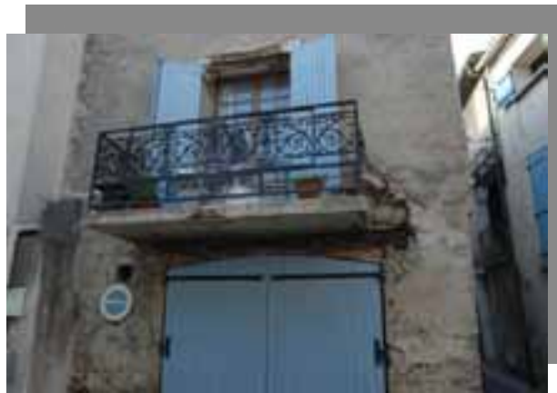
Figure 2 : Exemple de mur qualifié de « vétuste » (Source : CETE Méditerranée)
