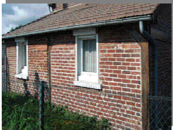
Figure 19 : Mur à ossature bois et remplissage en briques pleines (Source : CETE NC, INERIS)
