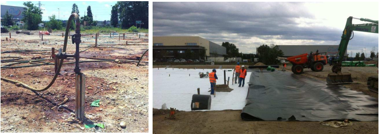
Photos 1 – Stabilisation chimique par injection dans un des puits d’injection et pose de la membrane étanche sur lit de sable et géotextile en 2012 (source : rapport de fin de travaux ARCADIS)
