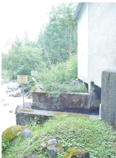
Pied de berge au droit de la centrale Bonneval amont – Site de la prise d'eau
