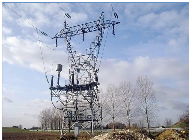
Pylône aéro-souterrain - Famille M1 - 1 circuit 225 000 volts © RTE, 2013 Emprise au sol : 45 à 80 m 2 , Envergure : 15 m, Hauteur : 23 à 42 m
