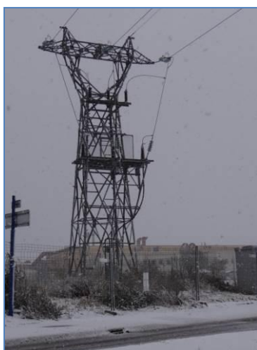
Pylône aéro-souterrain -1 circuit 63 000 Volts © RTE, 2013 Emprise au sol : 20 à 50 m 2 , Envergure : 8,5 m, Hauteur : 13 à 30 m
